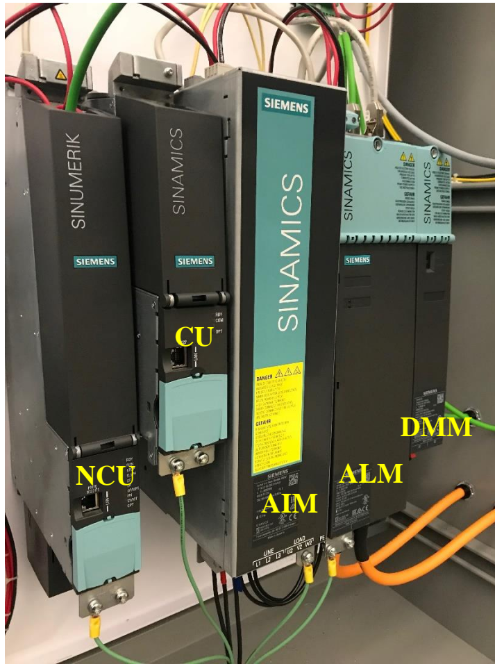
Fig. A.3. Assembled controller modules.
