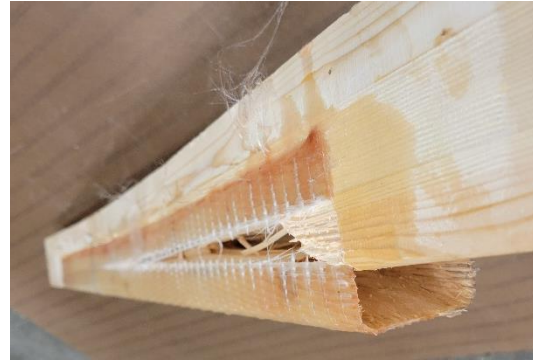
(d) Close-up of damage for R3-02
