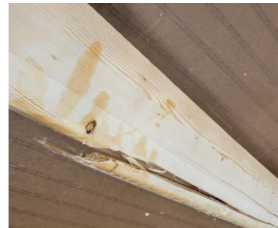
(d) Close-up of damage for R2-02
